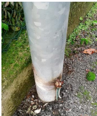
Messa a terra del punto luce comunale.
